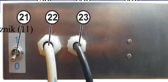
Rys. 6/1 Elementy tablicy rozdzielczej
